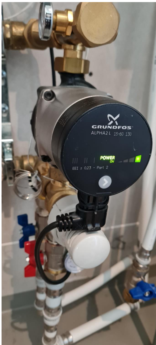
BILD: Pumpen är felinställd då diodmätaren till höger är ställd på nivå 4.
